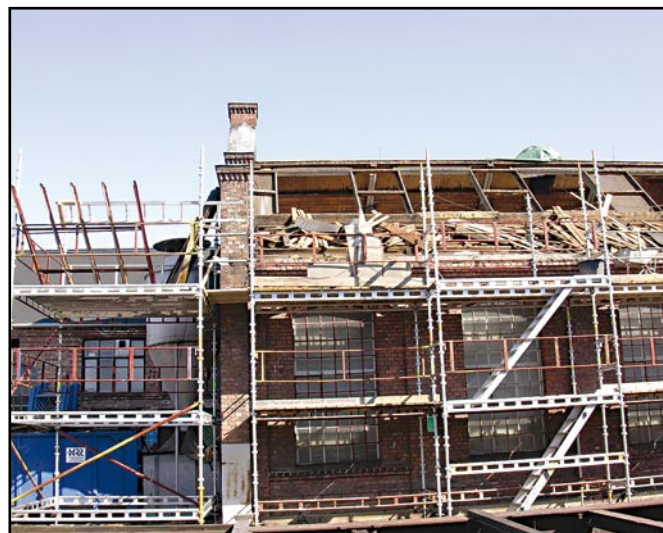
Takarbeid på presenningsverkstedet 25. april 2009. Taket er ferdig lagt på presenningsstørken til venstre, mens det gamle taket er revet på den eldste delen av bygningen. Andreas Dreyer, NJM
